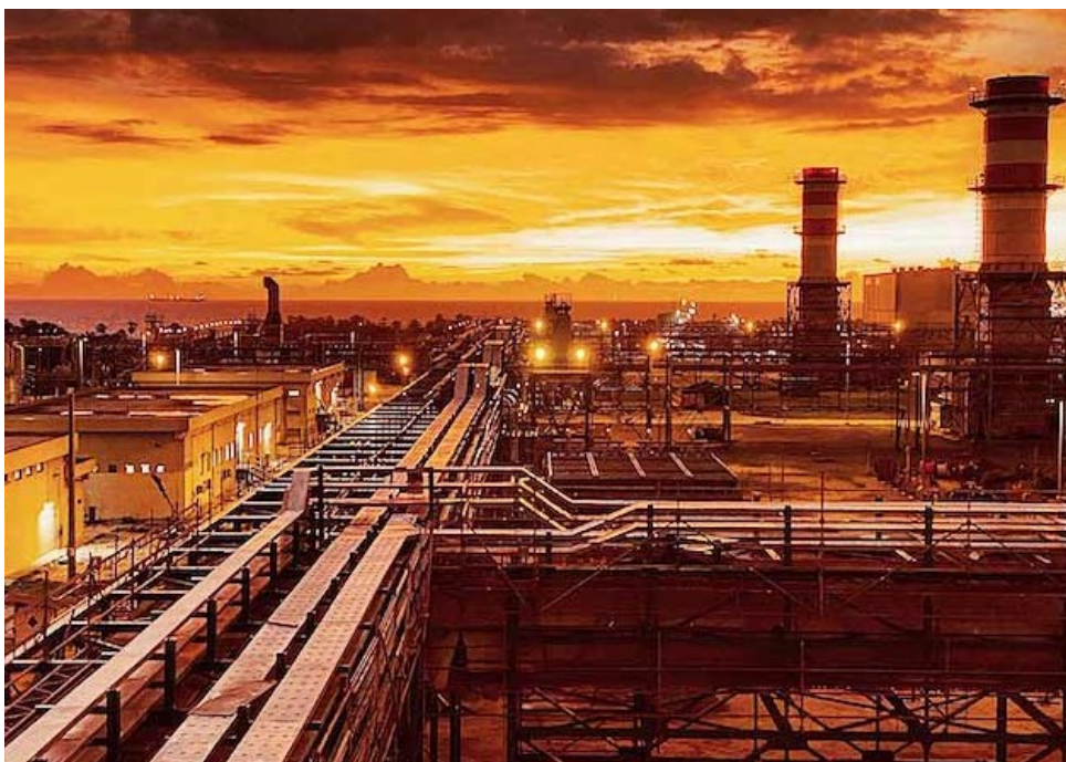
La Centrale électrique du Congo à Pointe-Noire
